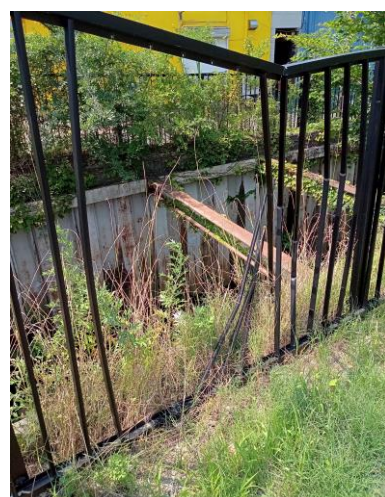
遊歩道の破損した柵
