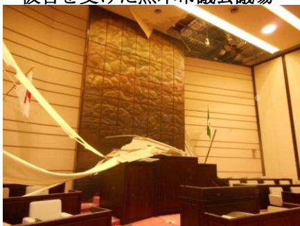
被害を受けた熊本市議会議場
